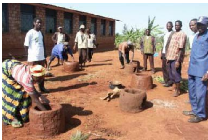
Construction of improved jikos. Construction des jikos améliorées. Photo: Leonidas Nkezabahizi, ABO.
